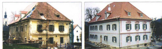
Abb. 7: Wies, Ratbaus, Anfang 19. Jb.; Links: vor der Restaurierung; rechts: nach der Restaurierung von Nord- und Westfront.
