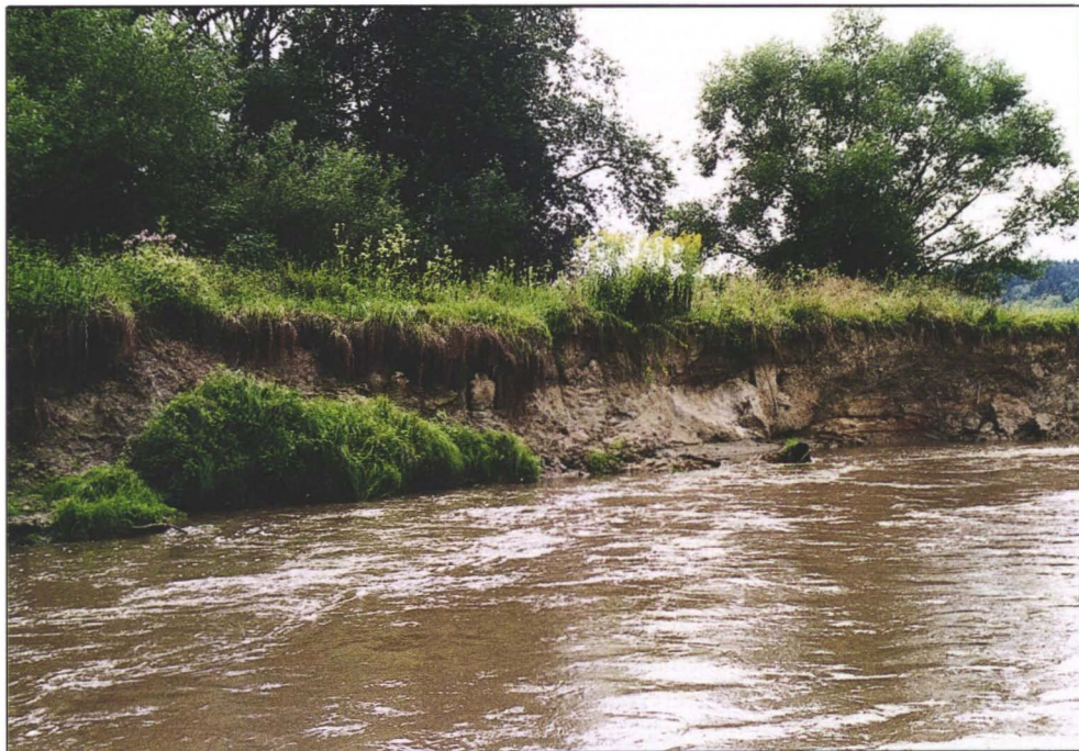
Uferabbruch an der Lafnitz
