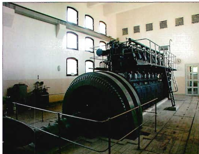
Abb. 3: Sender Dobl, Dieselaggregat
