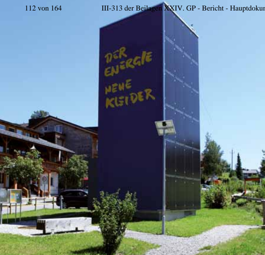
Umbau einer Trafostation zu einem Solar-Schaukraftwerk als Ausgangspunkt für den Energieweg in Langenegg, Vorarlberg (fink thurnher architekten, 2006)
