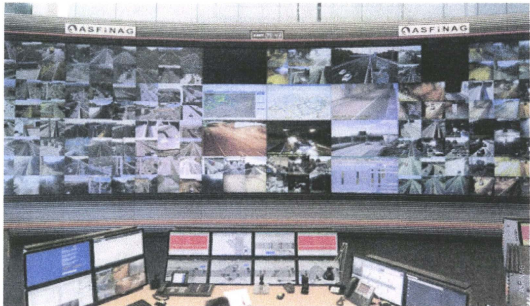
Abbildung 7: Die Verkehrsmanagementzentrale der ASFINAG
