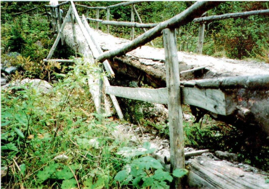
Abb. 118: Brückenschaden am Sarotlabach
