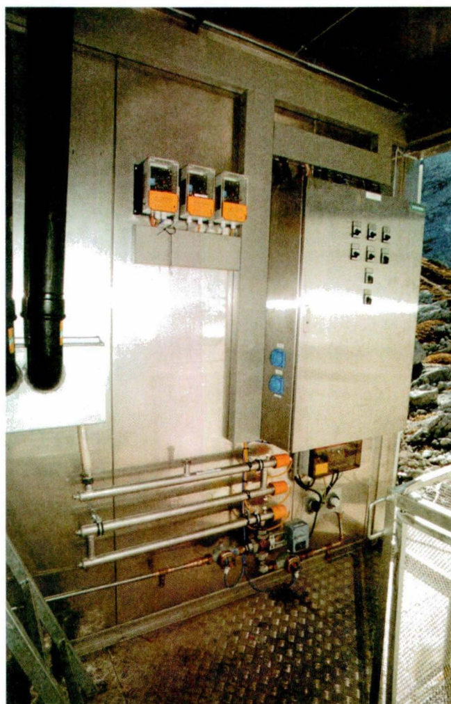
Abb. 61: Container „Technik“: UV-Filteranlage
