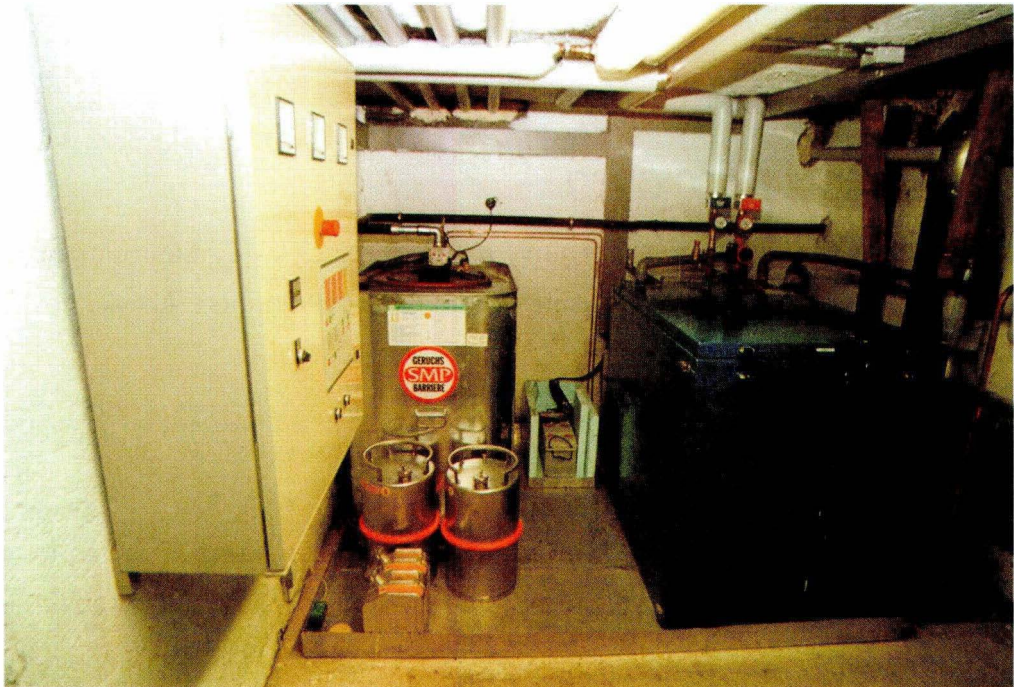
Abb. 57: Blockheizkraftwerk, doppelwandiger Tank, dichte Auffangwanne
