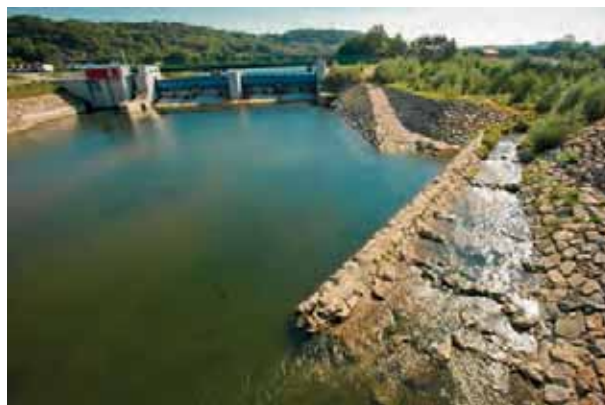
Wasserkraftwerk in Kemmelbach; rechts naturnaher Beckenpass
