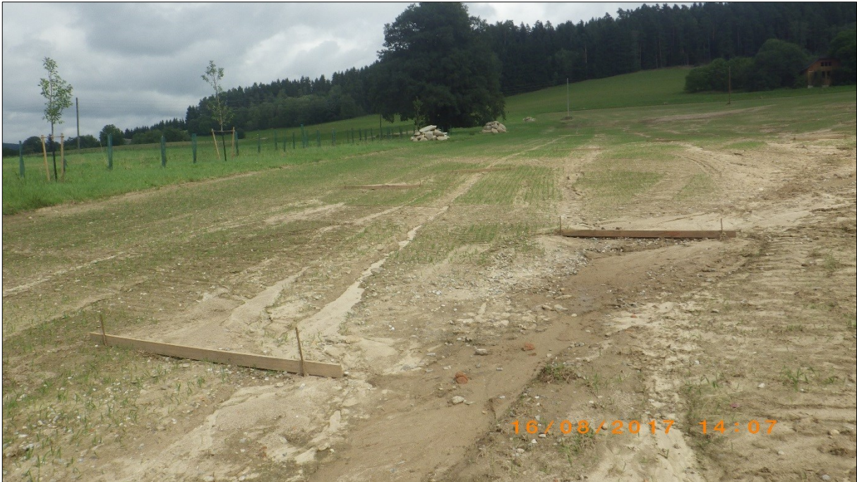
Abbildung 6: Abplankungen des Hangs an besonders exponierten Stellen
