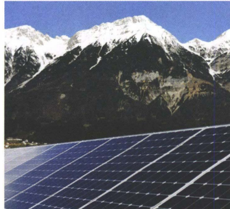
Seit 2010 ist ein deutlicher Anstieg der Leistung aus Photovoltaikanlagen erkennbar. Mit 590 MW machten diese 2014 etwa 2,4 % des österreichischen Kraftwerksparks aus.
