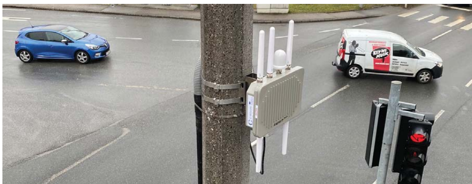
Abbildung 14: Installierte RSS in Salzburg © Salzburg Research
