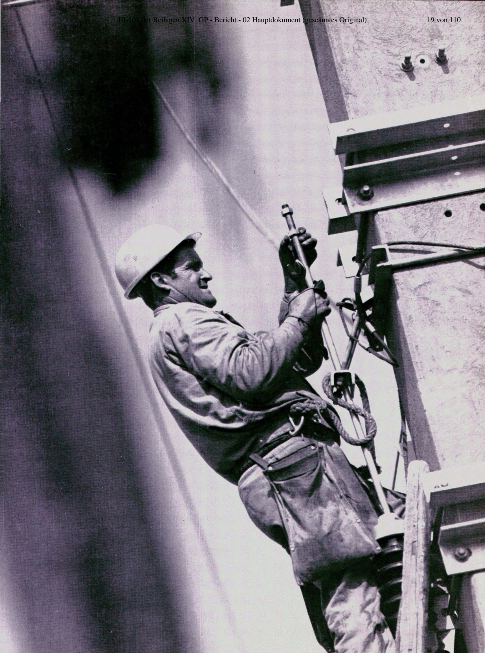
Bild 3 Um bei Arbeiten an und in der Nähe von Fahrleitungsanlagen Hochspannungsgefährdungen zu vermeiden, müssen die Bestimmungen des elektrotechnischen Vorschriftenwerkes genau beachtet werden. www.parlament.gv.at
