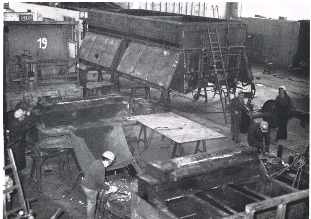
Abb. 15: Der Wagenwerkstätte obliegt neben der Instandhaltung des mehr als 1000 Stück umfassenden Wagenparks die Entwicklung spezifischer Konstruktionen für die Transportaufgaben eines Stahlwerkes
