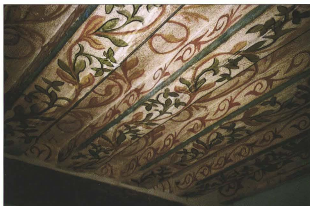
Abb. 2: Salzburg, Getreidegasse 32, Decke nach Restaurierung
