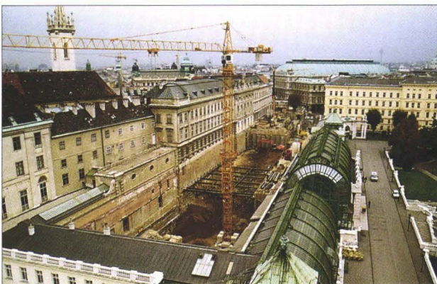
Blick auf die Baugrube in der Studiengebäude, Tiefspeicher und Wechselausstellungsballe entstehen werden
