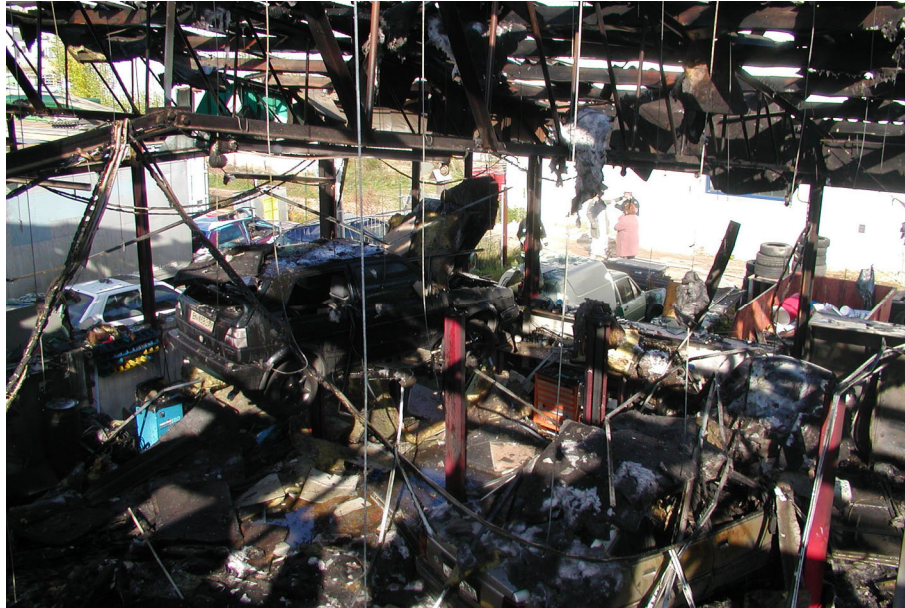
Die zwei zerstörten Außenwände und die abgehobene Dacheindeckung
