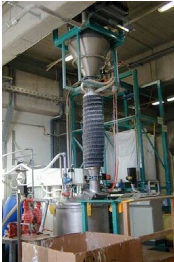
Automatische Dosierstation mit Wiegeeinrichtung und Sackstation
