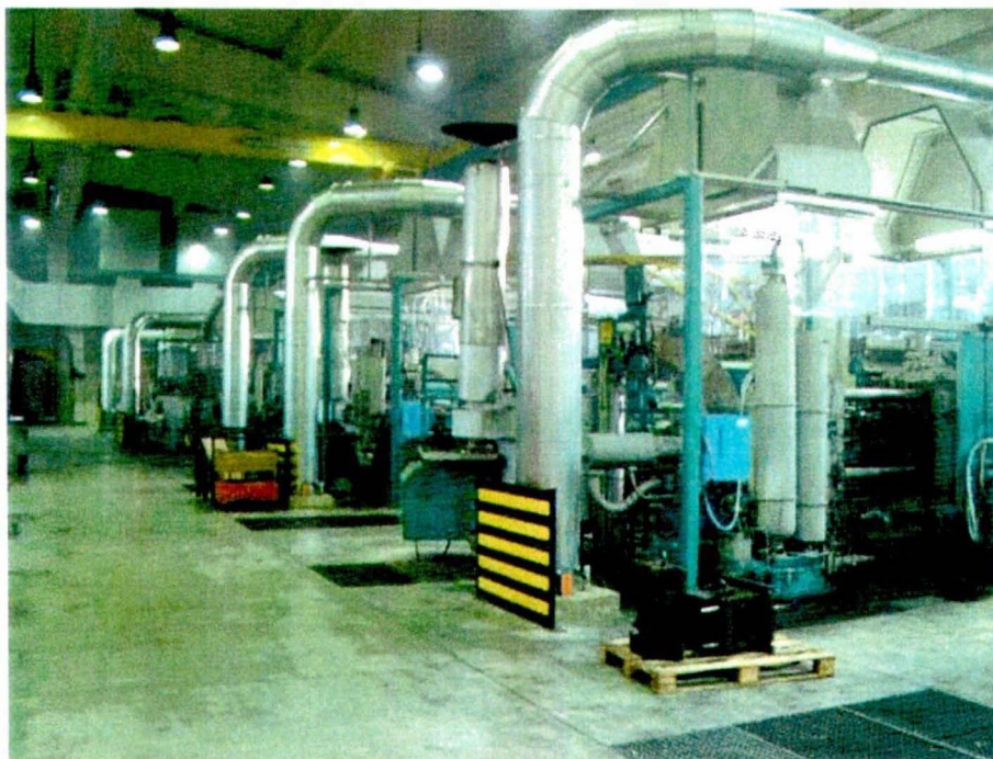
Absauganlagen bei Druckgussmaschinen
