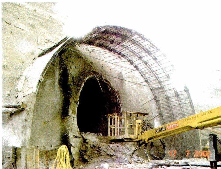
Luftbogenstrecke mit Zusatzmaßnahmen nach der Evaluierung
