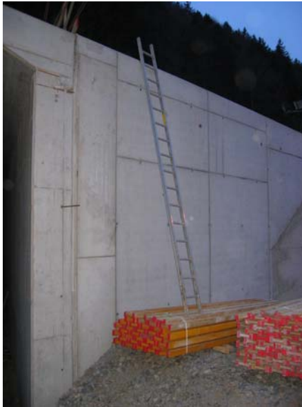
Unzulässige Aufstellung, keine Sicherung gegen Wegrutschen und Umfallen
