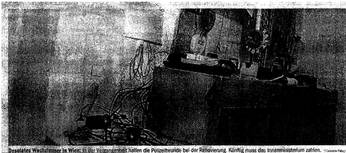
Desolates Wachzimmer in Wien: In der Vergangenheit halfen die Polizeifreunde bei der Renovierung. Künftig muss das Innenministerium zahlen. (Caroline Fabry)
