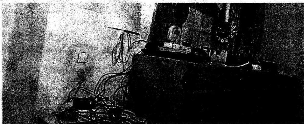
Desolates Wachzimmer in Wien: in der Vergangenheit halfen die Polizeifreunde bei der Renovierung. Künftig muss das Innenministerium zahlen. (Clement Fabry)
