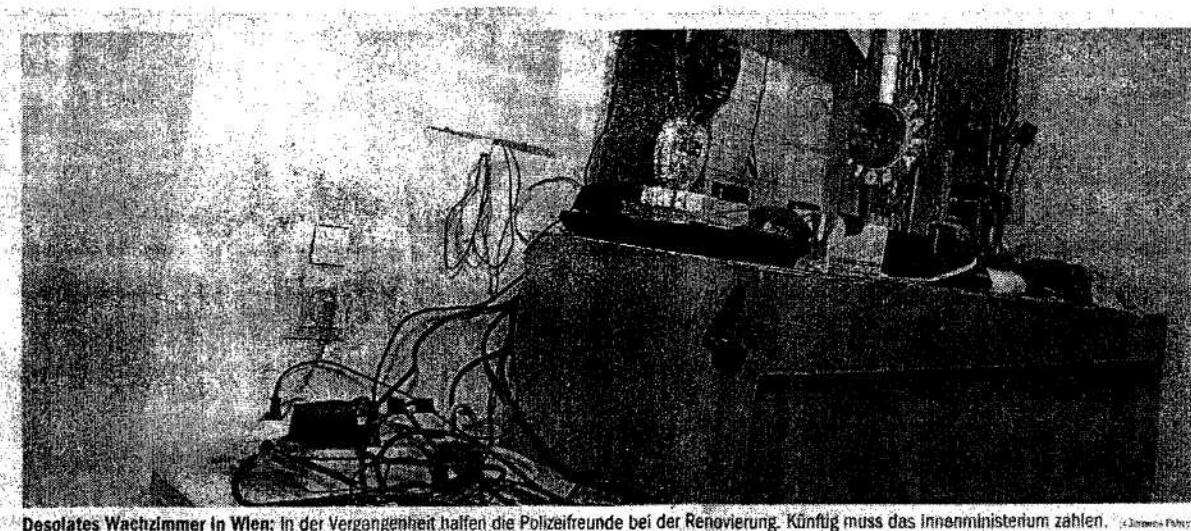
Desolates Wachzimmer in Wien: In der Vergangenheit halfen die Polizeifreunde bei der Renovierung. Künftig muss das Innenministerium zahlen. (© Johannes Pöschl)
