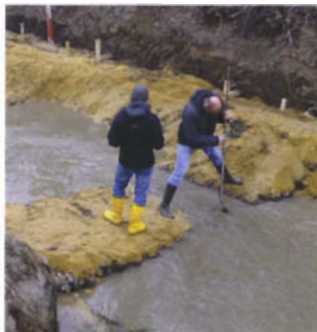
Fischwanderhilfe bei der Abzweigung des Ebendorfer Mühlbaches in Mistelbach
