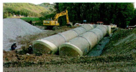
Oben: Transport der Fertigteile für den Hochbehälter Mitte: Versetzen der Fertigteile für den Hochbehälter Unten: Fertigstellung Hochbehälter Thal
