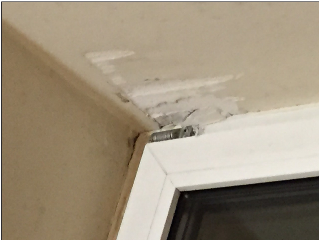
Desolate Decken mit Schimmelspuren
