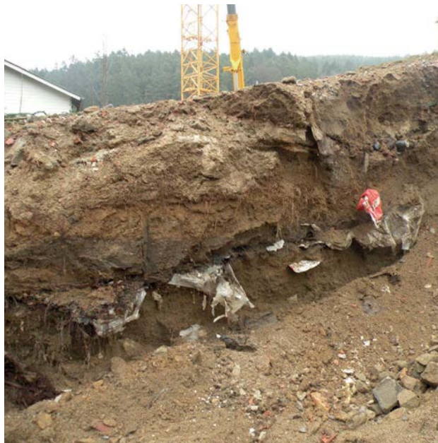
Abbildung 6: Verunreinigtes Erdreich im Baulos 4.1
