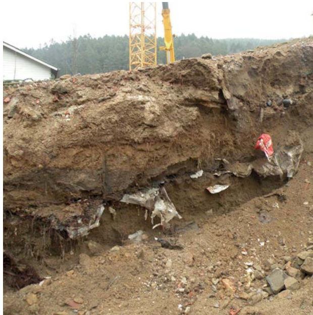
Abbildung 6: Verunreinigtes Erdreich im Baulos 4.1
