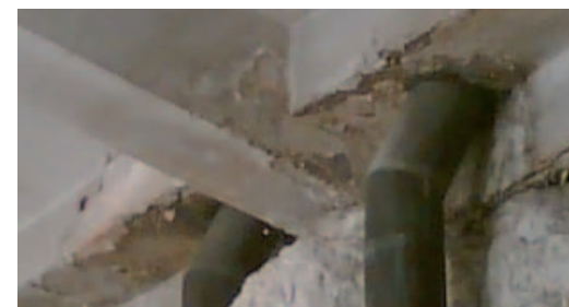
Schäden am Kupferblechdach über dem Mitteltrakt © Parlamentsdirektion/Andrea Schenk
