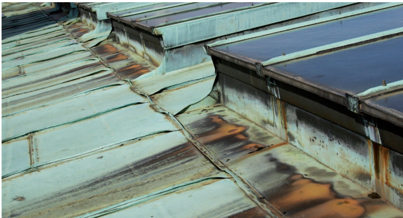
Dach des Parlamentsgebäudes: Korrosionsschäden am Kupferblechdach © Parlamentsdirektion/ Mike Ranz
